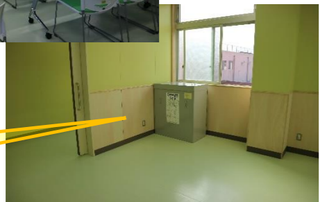
多目的室の非常用避難器具
